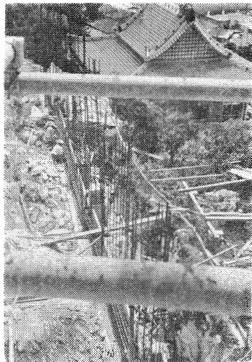
この地割れの数秒前に直径二メートルほどの別の大岩が一個落下した。落下地点はこの家の主婦が立っていたが、洗濯物を取りに行った直後の一瞬の出来事だった。人身事故と直接の物的損害がなかったのは不幸中の幸というべきである。
